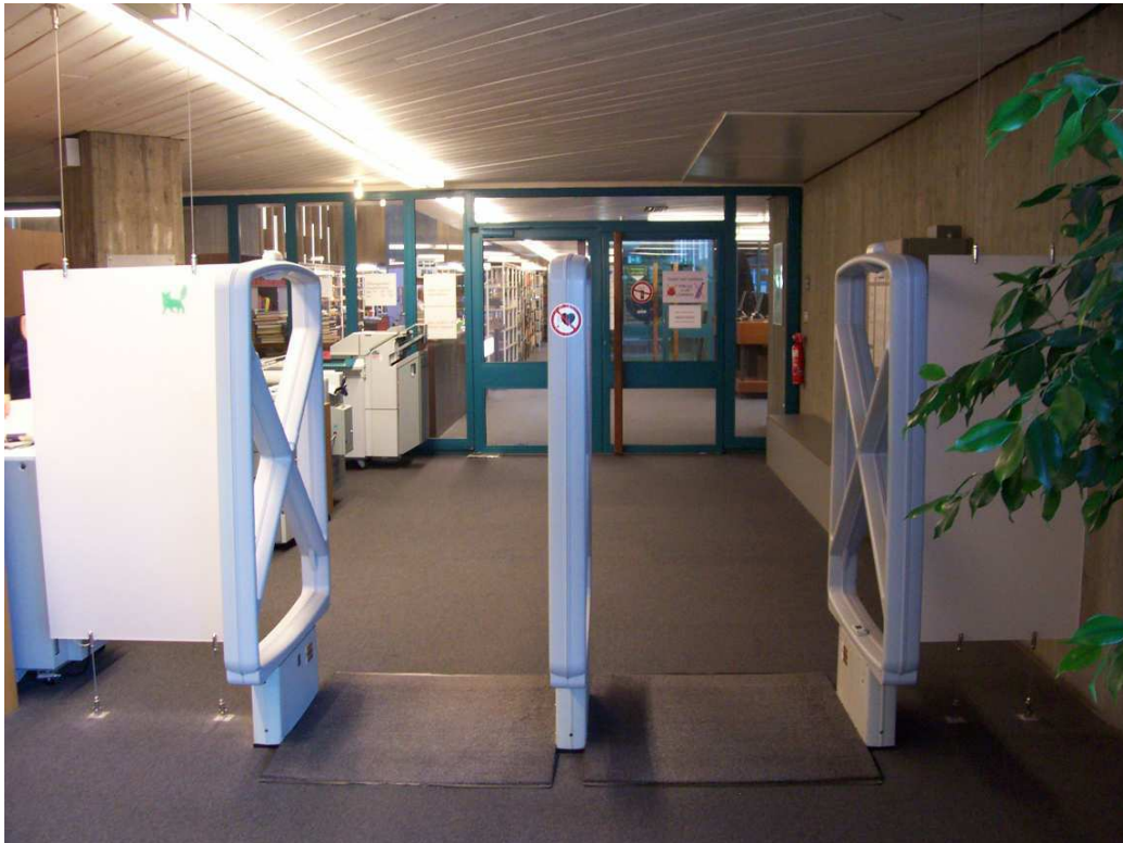
Abbildung 6: Durchgangsleser der Firma 3M im Eingangsbereich des Lesesaals der WLB Stuttgart
